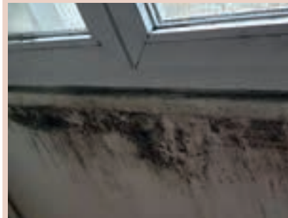
Des logements humides et mal isolés phoniquement et thermiquement.
